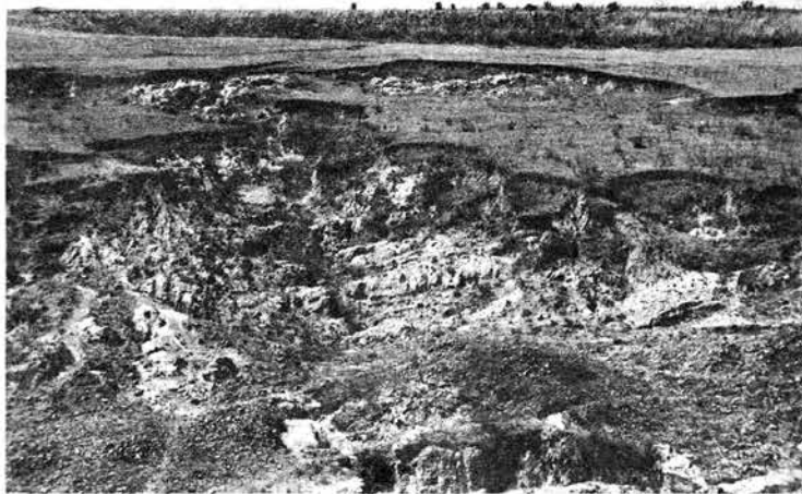
Figura 20. Detalle del hundimiento generalizado del terreno, producto del drenaje hipodérmico, al brotar a la superficie a partir de la cual se inicia el proceso erosivo de las laderas.
