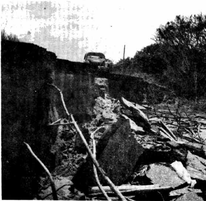
Foto 2. Vista parcial de los restos del terraplén y carpeta asfáltica de la carretera en cuestión. (Foto de mayo de 1992.)
