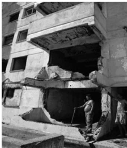
Figura 12. Afectación a las edificaciones sólidas costeras por acción de la fuerza del mar en Baracoa, huracán Ike, 2008.
